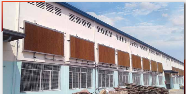
Hệ thống làm mát - thông gió nhà xưởng Factory cooling - ventilation system
